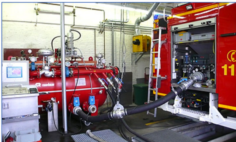
Prüfeinrichtung der etewe: Der Einsatz eines Vakuumtanks spart Installationskosten.
